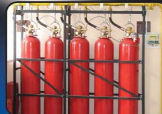
Системы газового пожаротушения FE13 (R23)
